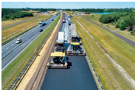
Fot. 1. Remont nawierzchni autostrady A2 Konin – Dąbie (źródło: COLAS Polska Sp. z o.o.)
