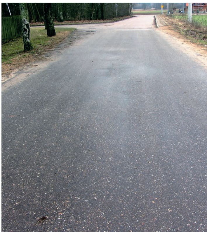
Fot. 7. Beton asfaltowy emulsyjny po czterech latach eksploatacji
